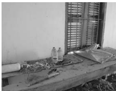
荒れ果てた建物の中。 壊れた机に試薬が置かれたまま
